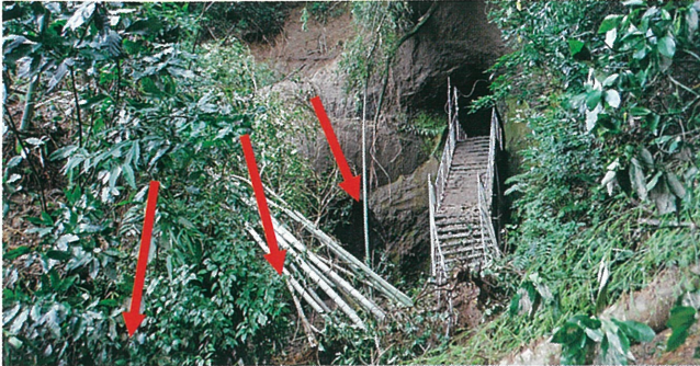
湯前町浜川地区 幸野溝小水力発電所周辺 土砂崩れ及び管理用階段崩壊
