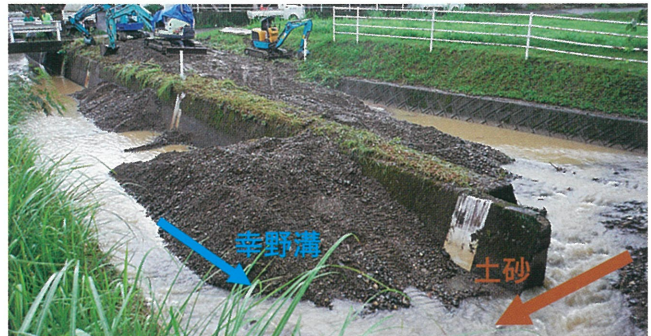
多良木町奥野地区(中山観音付近) 幸野溝土砂流入(約150㎡)
