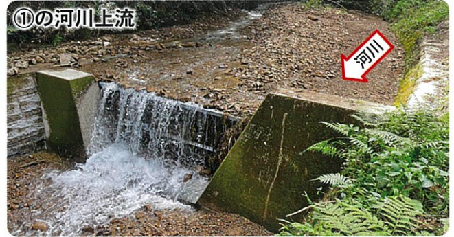
①の河川上流 【湯前町馬場地区】 沈砂池の土砂堆積状況
