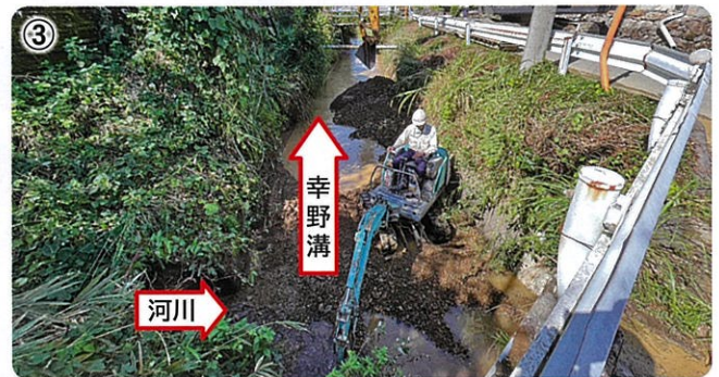
③【あさぎり町宮麓地区】 土砂約68m 3 が幸野溝へ流入
