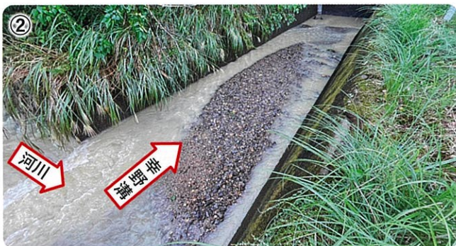
②【多良木町奥野地区 中山観音付近】 土砂約60m 3 が幸野溝へ流入
