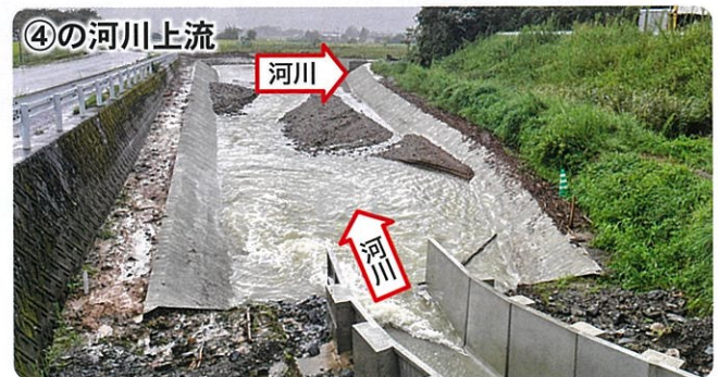
④の河川上流 【あさぎり町永岡地区】 沈砂池の土砂堆積状況
