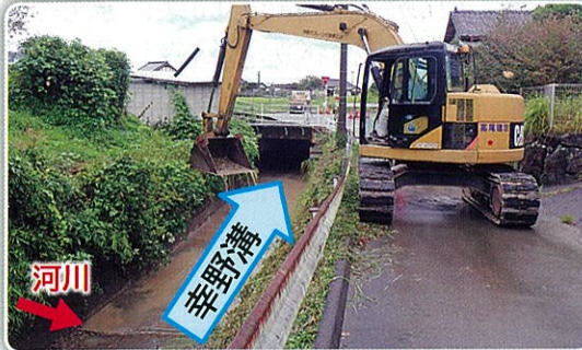
【あさぎり町宮麓地区】 土砂約45m 3 が幸野溝へ流入
