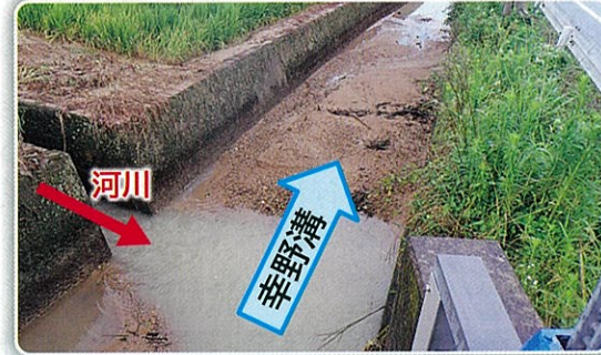
【あさぎり町永岡地区】 土砂約60m 3 が幸野溝へ流入
